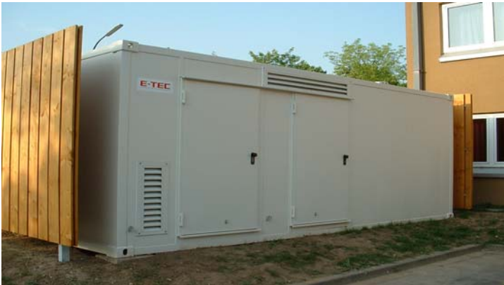
20" Container mit elektrischem Betriebsraum für USV +NEA
