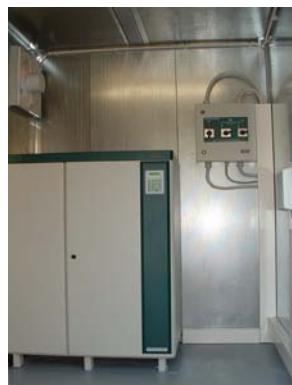
USV-Anlage 40kW mit Abluft-System und / oder Klimatisierung
