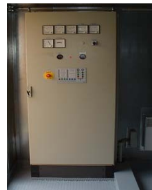
Notstromsteuerung mit Stromverteilung
