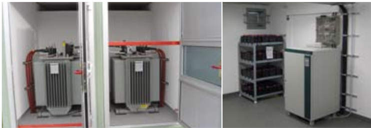
Trafostation mit 2 Transformatoren (redundant)
